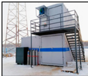
Установка утилизации дымовых газов с блоком получения синтез – газа на компрессорной станции Шатровская ООО «Газпром трансгаз Екатеринбург». Фото: Е. Понизовкина
