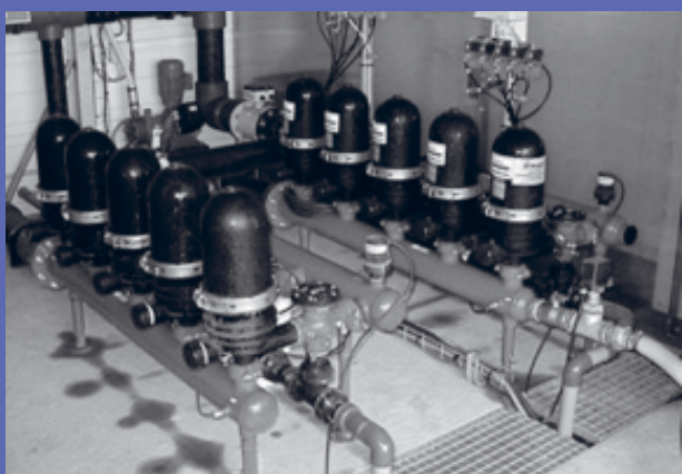
Рис. 10. Станция механической очистки отработанной воды OPAL
